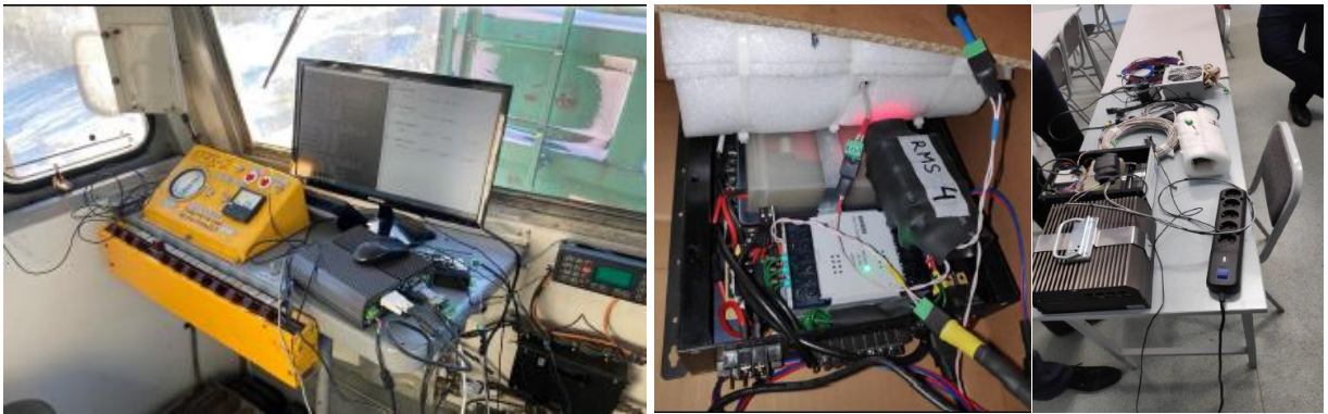
Рисунок 4.2 – Измерительное и коммуникационное оборудование на электровозе
