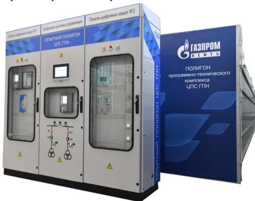
Рисунок 1 – ПТК «Цифровая подстанция» АО «Газпромнефть – ОНПЗ»
